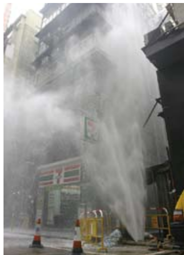
▲ 為免工程誤鑽喉管，專業的管綫規劃實在有其必要。圖為05年工人不慎擊穿鹹水管，引致油麻地南京街鹹水湧現的場面。
